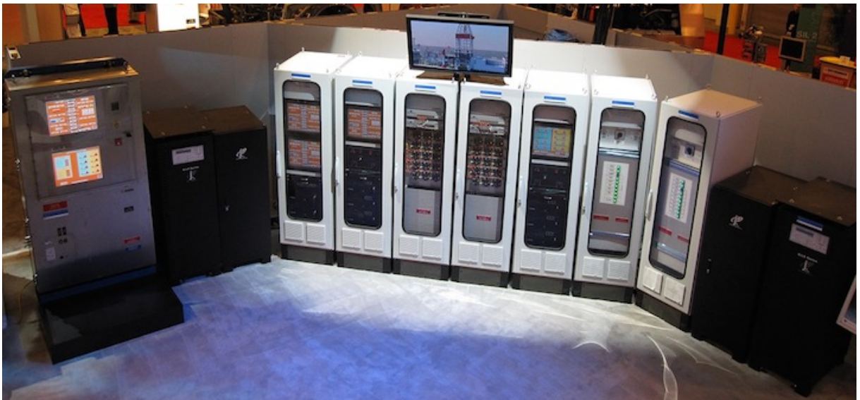
Figura 2.6: Painéis de controle de superfície (GE/HYDRIL, 2013)
